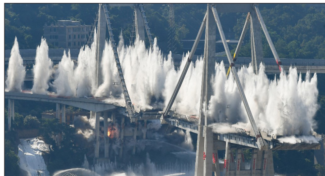
4. ábra: A Morandi-Viadukt vége © keystone-sda.ch
