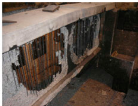
b) a betonfelület leválása
