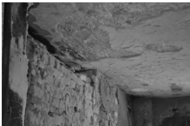
10. ábra: A betonfelület réteges leválása
