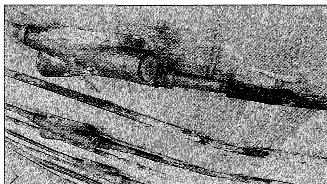
10. ábra: Betonkeresztmetszeten kívül elhelyezett feszítópázsma sérülése
