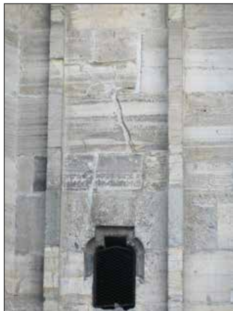
■ 5. kép: Közel függőlegesen eltört és szétcsúszott kváderek a déli mellékhajó falába illesztett lépcsőház ablaka fölött. © KÁZMÉR Miklós
