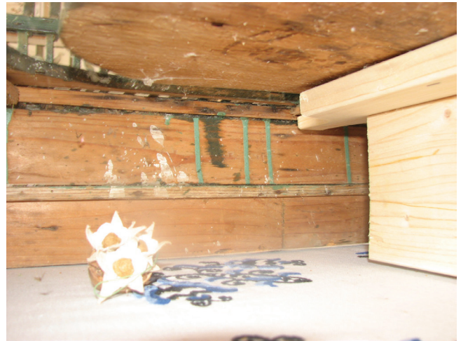
22. kép. Világoszöld és sötétzöld festéklecsorgások a betlehem belső oldalán és a megsüllyedt színpad alátámasztása. Restaurálás előtti felvétel
