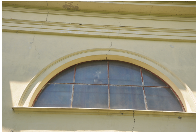
20. kép. A DNY-i ablak korrodálódott védőüvegezése, az elmozdult falazattal
