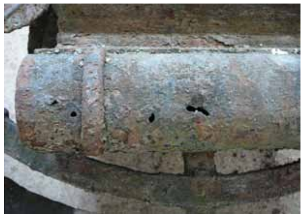
6. kép. A helyenként átkorrodálódott könyv részlete.
