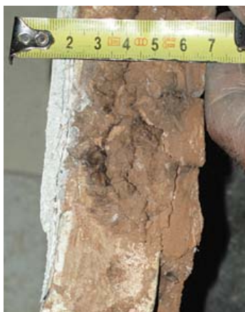
3. kép. A csempelapok között átégett tapasztás.
