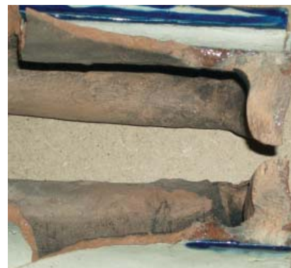
39. kép. Készítéstechnikai hiba, repedés.
