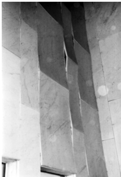
3. ábra. A meggörbült karrarai márvány-lapok a Finlandia palota homlokzatán.
