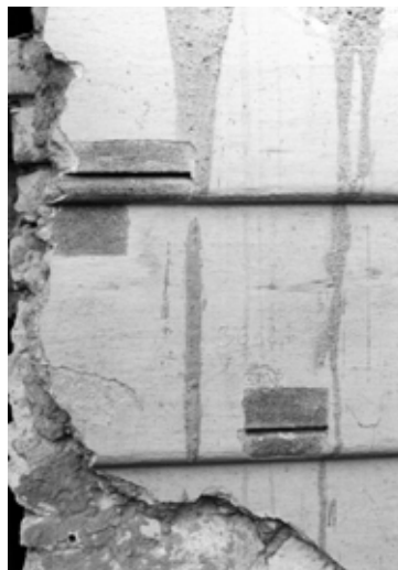
8. ábra. A koronázó párkány eredeti profilozása. A vakolás felső rétege festetlen, követ imitáló kőporos vakolat. A pálcátagot az 1960-as években tüntették el.
