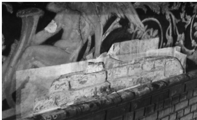
26. ábra. Andrassy út 102. A freskó egy részének „stacco” technikával történt leválasztása és a meggyengült alsó vakolat eltávolítása után előtűnt a károsodás egyik oka, egy feltehetőleg aktív szerkezeti repedés.
