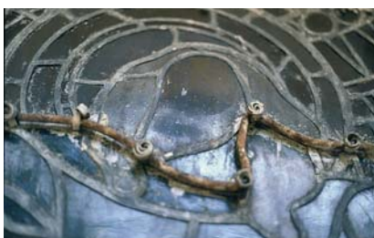
14. kép. Erősen korrodálódott merevítővas
