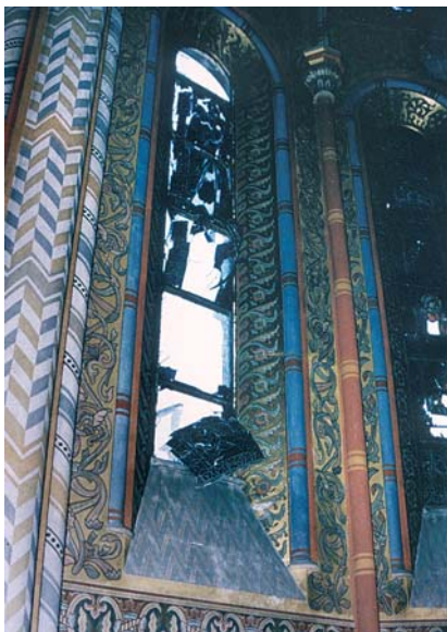
1. kép. Bombamerényletben károsodott üvegfestmény
